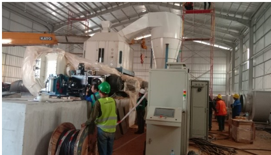
Gambar 4. 22 Instalasi motor dan sensor pada mesin pelletizer ke panel control
