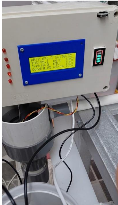
Gambar 4. 12 Kondisi Perangkat dan Susunan Chamber Saat Pengujian di Lapangan
