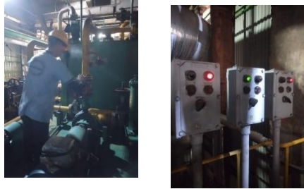
Gambar 4. 16 Test Pompa oli AC dan DC
