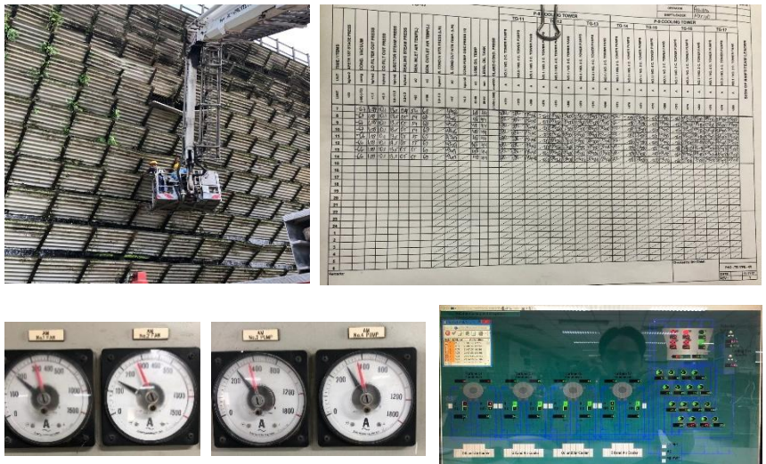
Gambar 4. 7 Perawatan , logsheet, amper fan dan motor serta monitor untuk pemantauan level dan temperature cooling Water
