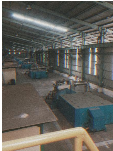
Foto Turbin – Generator di Unit PG-2
