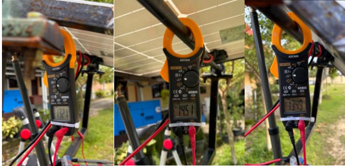
Gambar 4. 10 Pengukuran Tegangan Output Panel Surya
