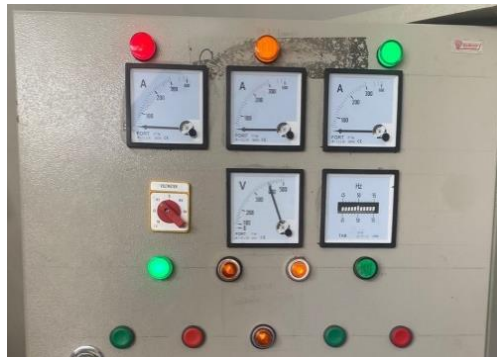
Gambar 4. 3 Kontrol dari Genset 1
