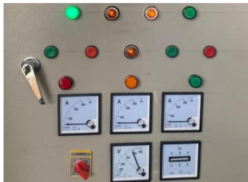
Gambar 4. 4 Kontrol dari Genset 2
