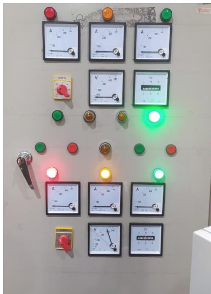
Gambar 4. 8 Ketika beban sudah di pindahkan pada sumber Genset 2
