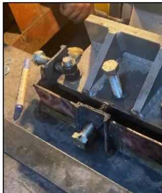
Gambar 4. 8 Bendungan Resin Chocking (Sumber: Pribadi)
