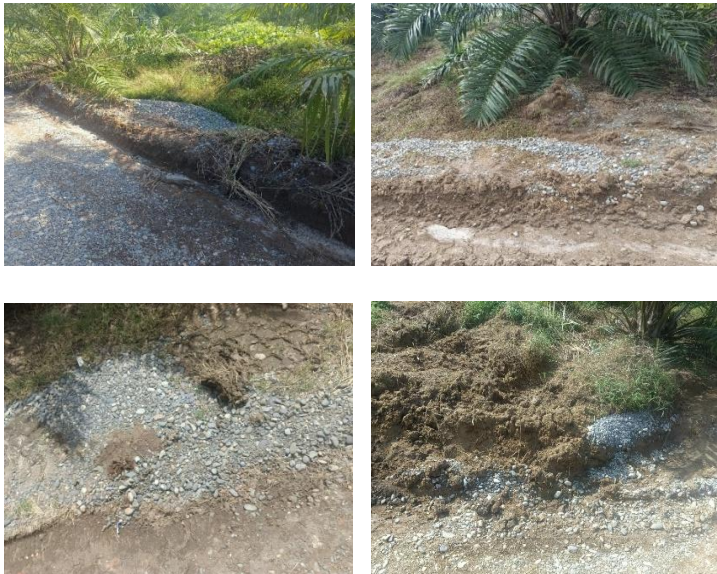
Gambar 4. 7 Dokumentasi Loses Material di Sisi Jalan
