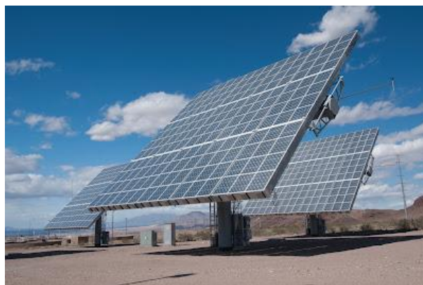
Gambar 2. 3 Pembangkit Listrik Tenaga Surya
