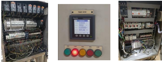
Pengecekan panel-panel dan penecekan Kwh setiap terafo Gambar
