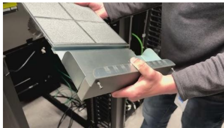
Gambar 3. 1 Pembersihan Filter Udara
