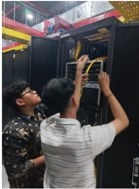
Gambar 4. 2 Melakukan Pengecekan Indikator Lampu
