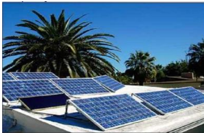
Gambar 2.1 Pembangkit Listrik Tenaga Surya (PLTS)
